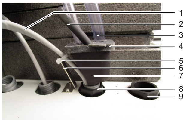
figura 3-25 Imbuto di raccolta per lo scarico comune di tutti i liquidi
